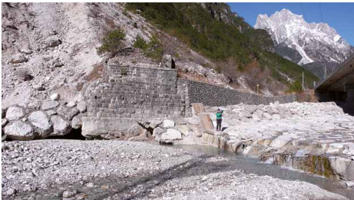
Fig. 32. Stato delle opere nell'alveo del T. Aupa nel tratto più a valle della stratta di Chiaranda (gennaio 2017). Al centro, la demolizione della soglia, ormai da vari anni, che ha favorito la profonda erosione del calcestrizzo che lega i grandi massi della platea a monte, predisponendola al parziale dissesto nella prossima grande piena. L'erosione del calcestrizzo interessa anche la scogliera a monte, sulla sponda destra, tratto che viene direttamente investito dalla corrente durante le piene. La scogliera a valle è stata in parte asportata in corrispondenza della spalla destra del vecchio ponte, la quale è completamente coperta dal conoide detritico ed ha la fondazione in parte sottoescavata, così come la scogliera a valle. Sullo sfondo la Creta Grauzaria con la sua DGPV ben evidente.
