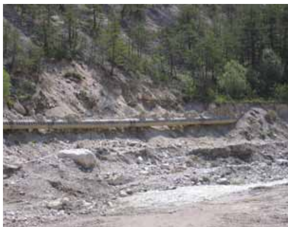
Fig. 27. Drammatici effetti erosivi della piena del 29 agosto 2003 sulla sponda sinistra del T. Aupa: la conduttura del primo gasdotto, che percorre tutta la Val Aupa, portata alla luce dopo la demolizione delle opere di difesa spondale.
